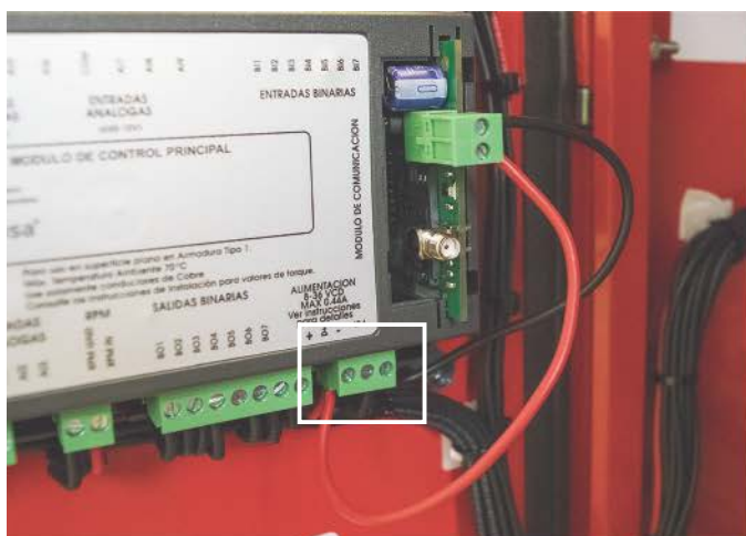
Terminal conectada en el módulo de control principal.
